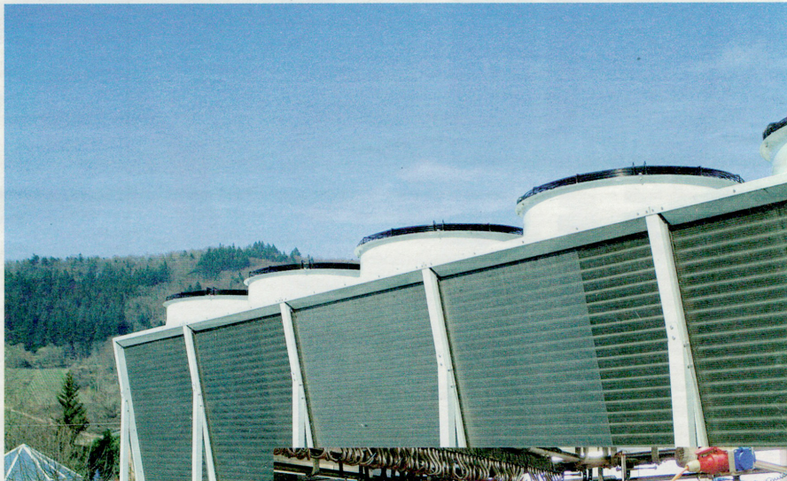
Der Verflüssiger auf dem Dach ist ein Bauteil der Kälteanlage. Darin wird das Kältemittel abgekühlt und solange Wärme entzogen, bis es verflüssigt ist. | Fotos: spe
